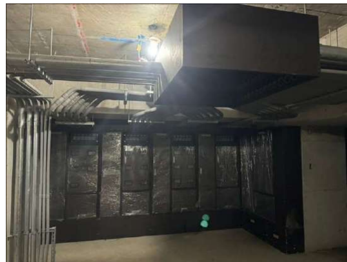
B1F電盤安裝完成
